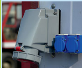
Steckdosen (unbekannte Schutzmaßnahme)
