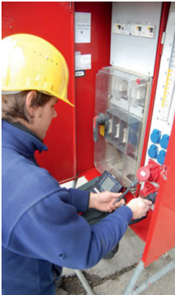
Abb. 10 Inbetriebnahmeprüfung eines Baustrom- verteilers nach VDE 0100-600
