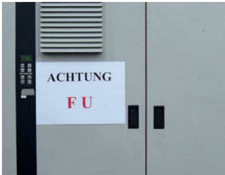
Abb. 6 Beispiel für die Kennzeichnung eines frequenzgesteuerten Krans, hier Anschlusschrank mit Frequenzumrichter (FU)
