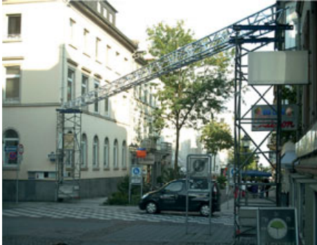
Abb. 1 Hochgelegte Leitung zur Straßenquerung
